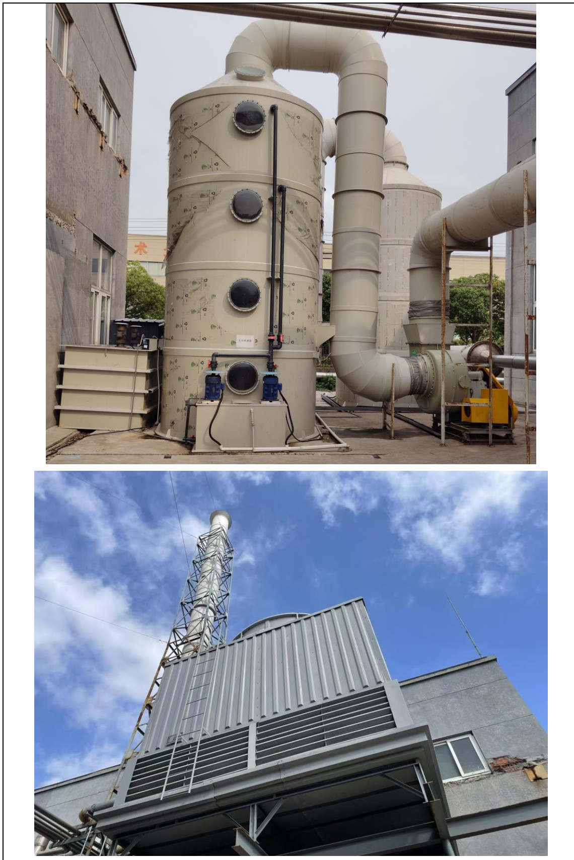
图4-11 废气处理设施及排气筒照片
