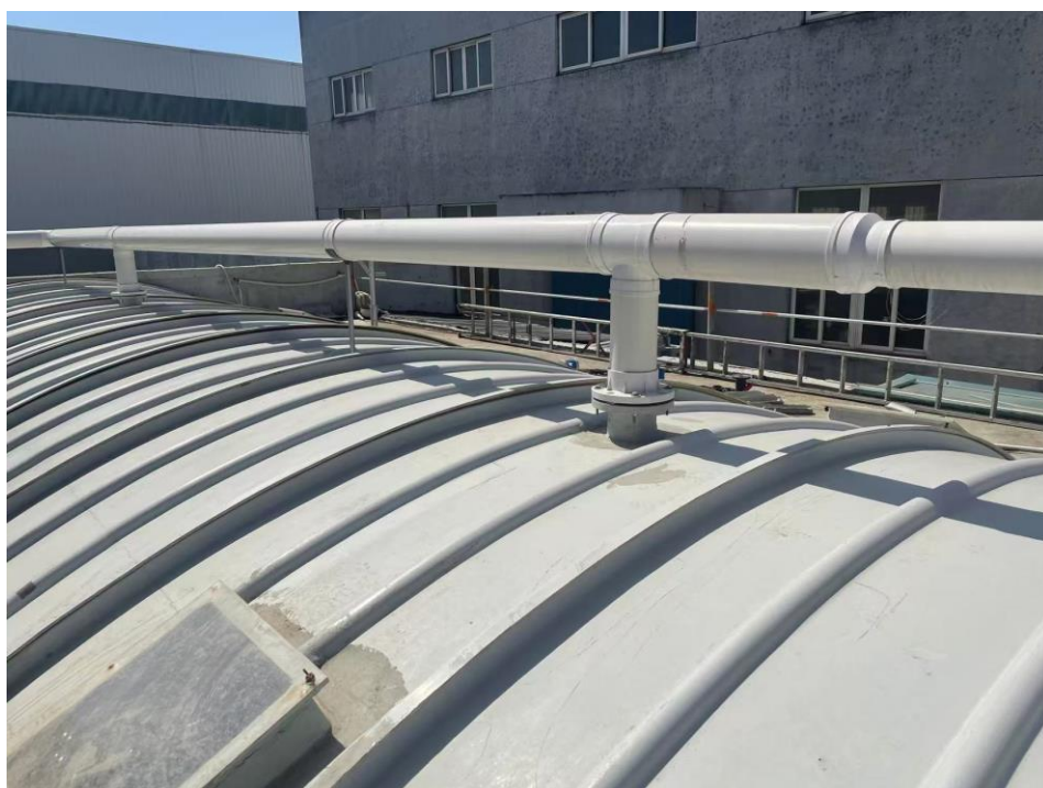
图4-7 污水处理站密闭收集
