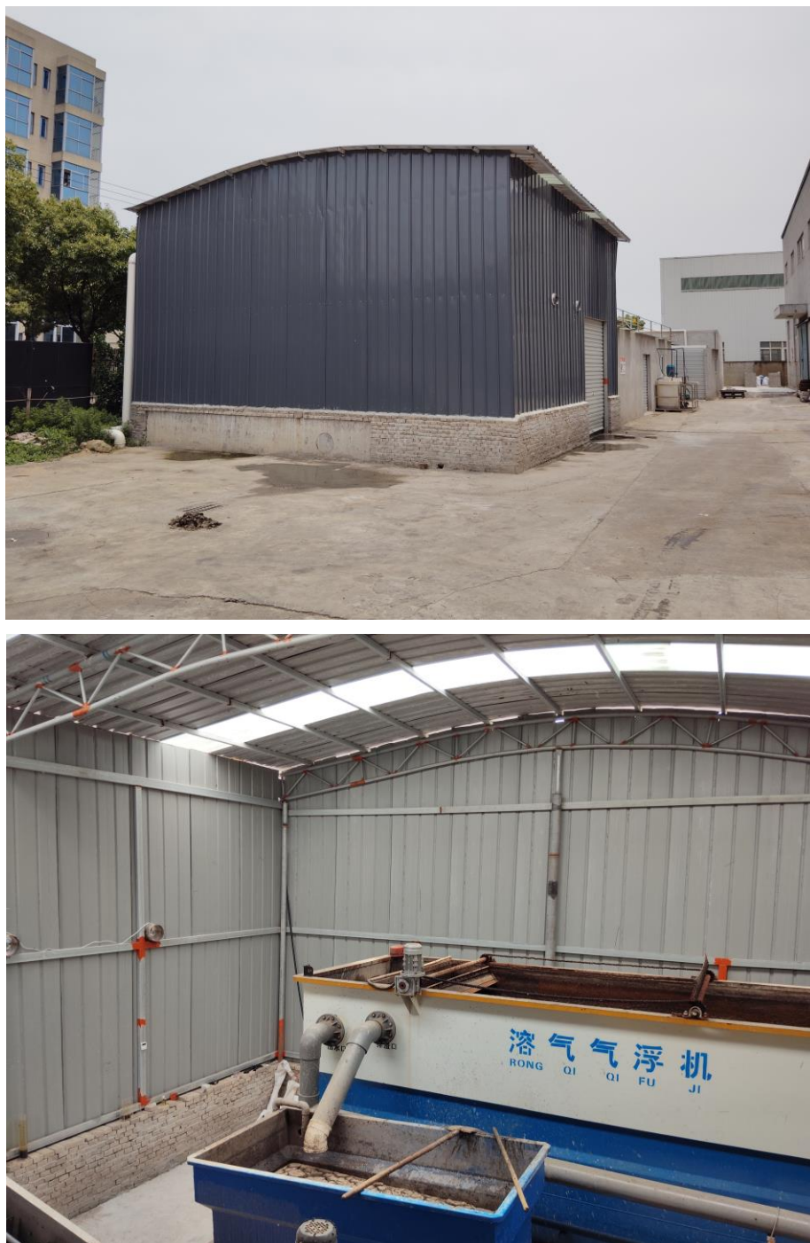
图4-5 废水处理设施图
