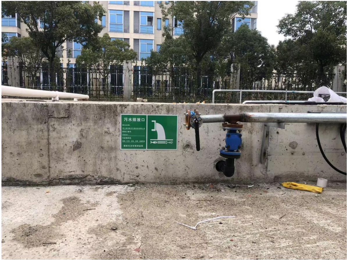
图4-15 废水排放口规范化排污口
