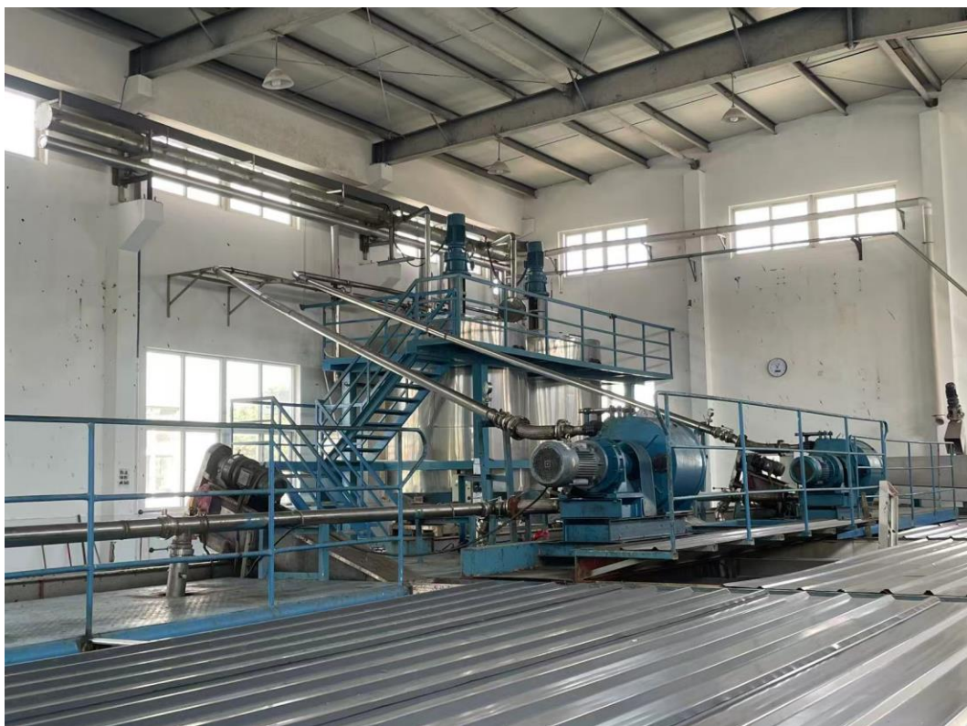
图4-9 鱼浆池加盖密闭
