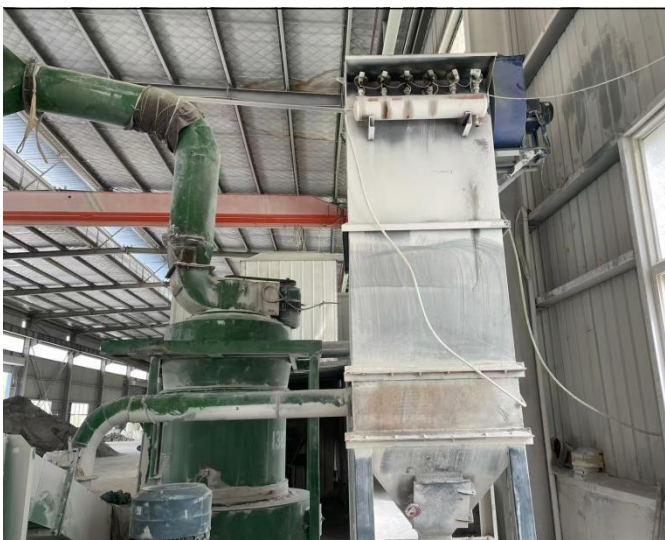
脉冲式除尘器
